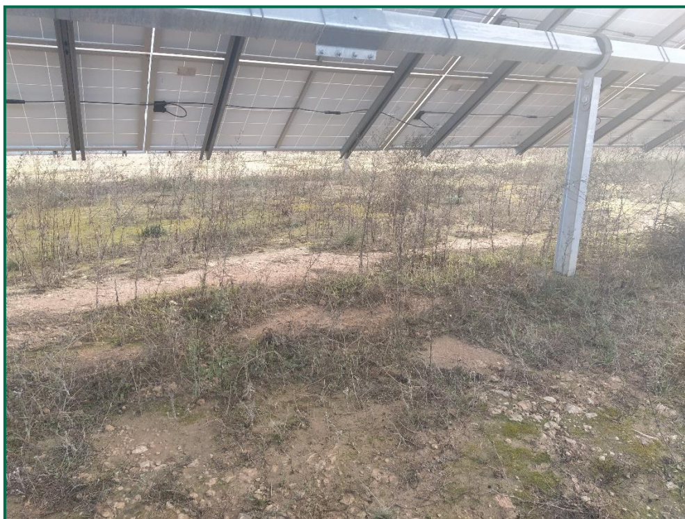
Fotografía 1. Vegetación entre placas actualmente.
